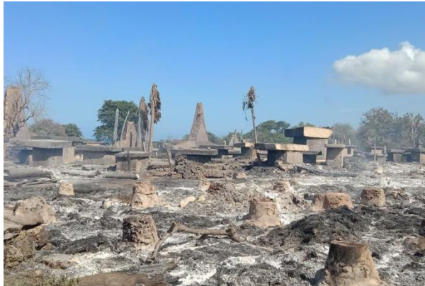
Gambar. 3 Kondisi Pasca Kebakaran Rumah Adat Suku Waihombo, Kec. Kodi Balaghar, Kabupaten Sumba Barat Daya, Nusa Tenggara Timur (NTT) Sumber: Kompas.com (2022)
